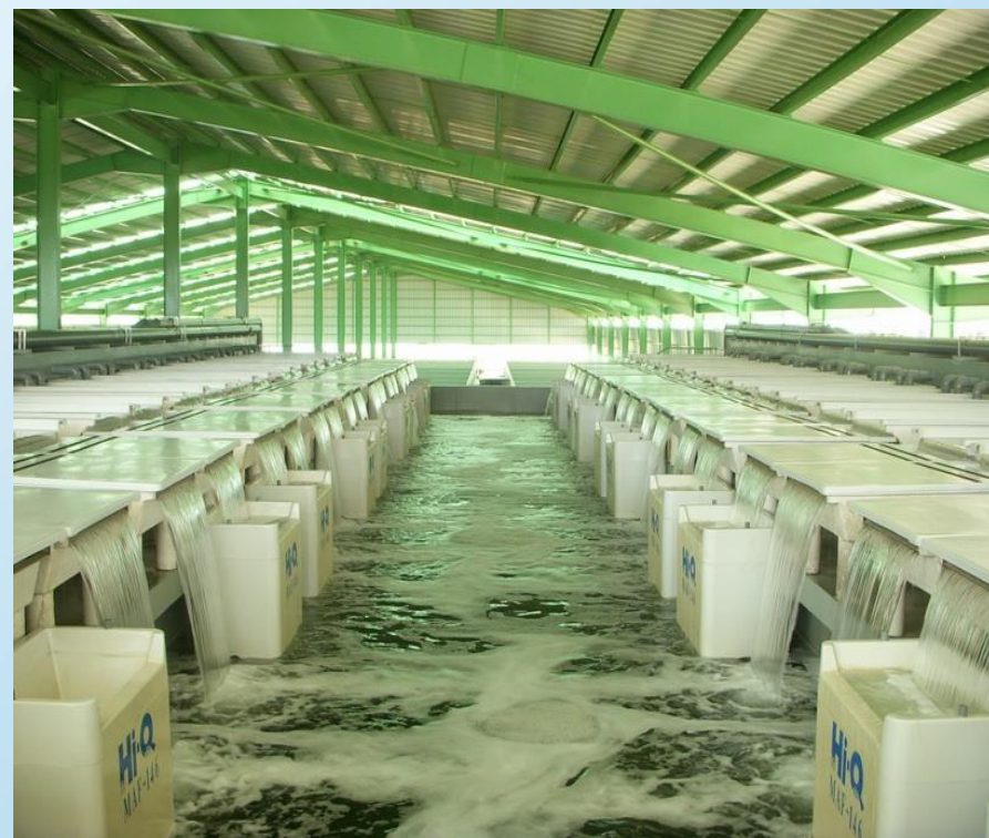
Water treatment area 水質處理區
