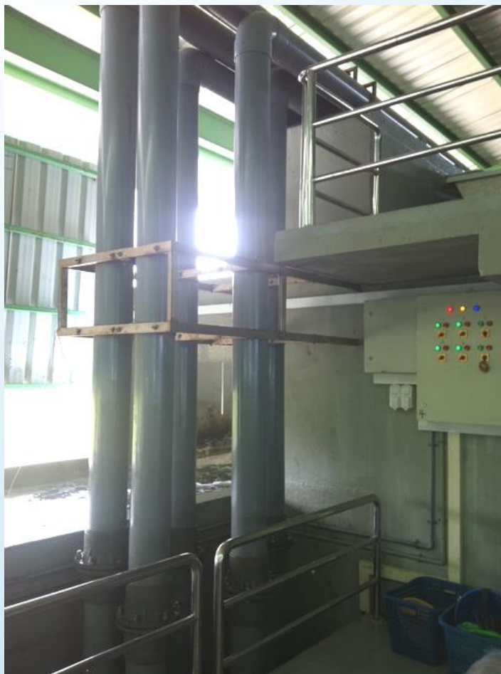
Recycle Pump 循環抽水機
